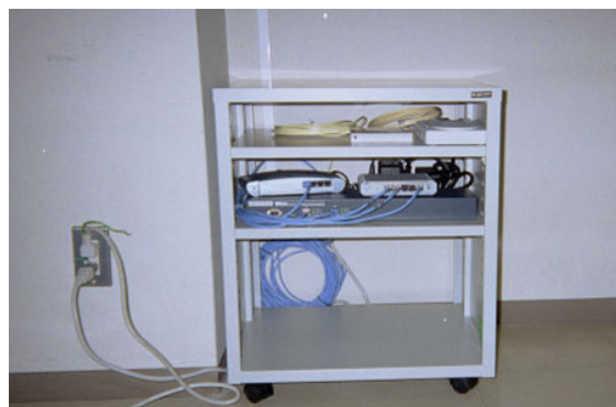
FTTH用ONU ルーター SW-HUB IPP-Server
