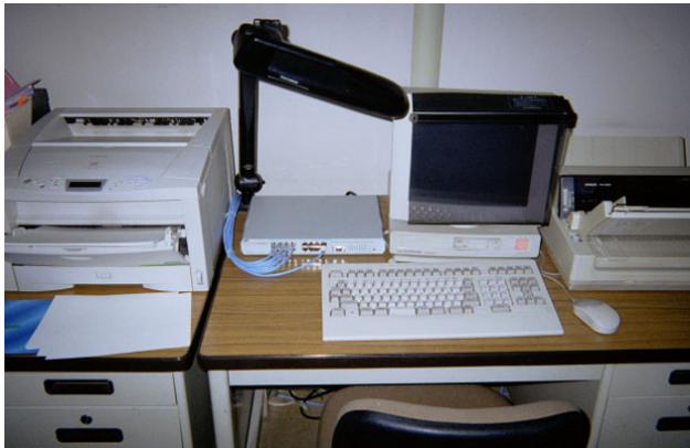
事務所内VLAN用SW-HUB設置
